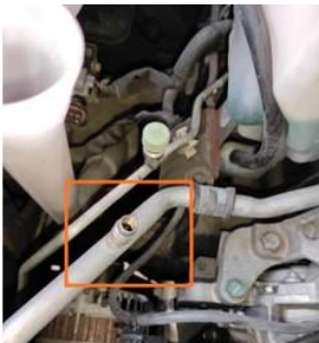
Tutup Nipple Pipa Freon Tidak Ada
